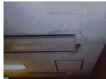
【空調設備(ファンコイル)】
